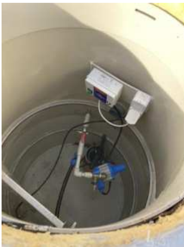
Obrázek 17: Vodní zdroj V-1, čerpací zařízení
